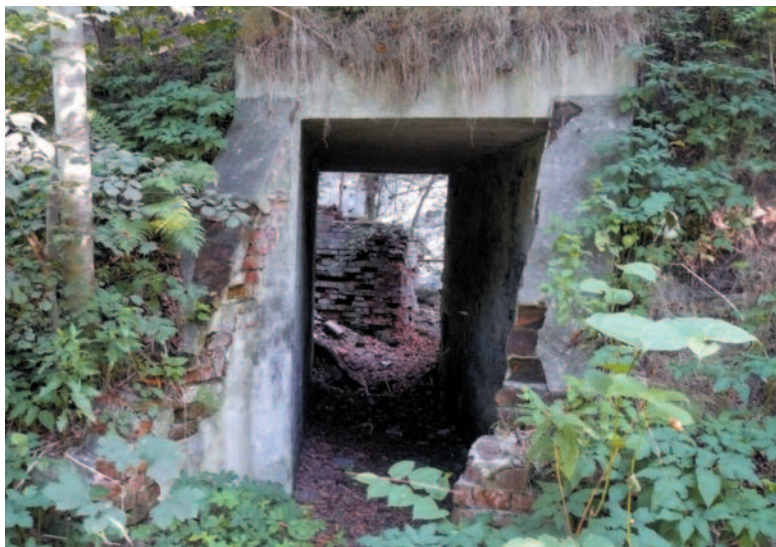
Ruiny budynków kryją historię...
