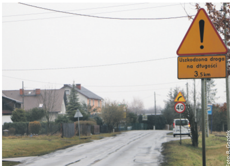
Znaki ostrzegające przed uszkodzeniami drogi nie są rzadkością na DW 921 – ale to nie rozwiązuje problemu.
