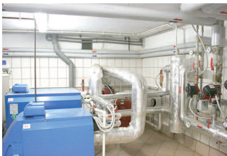
Kotły olejowe w zmodernizowanym obiekcie.
