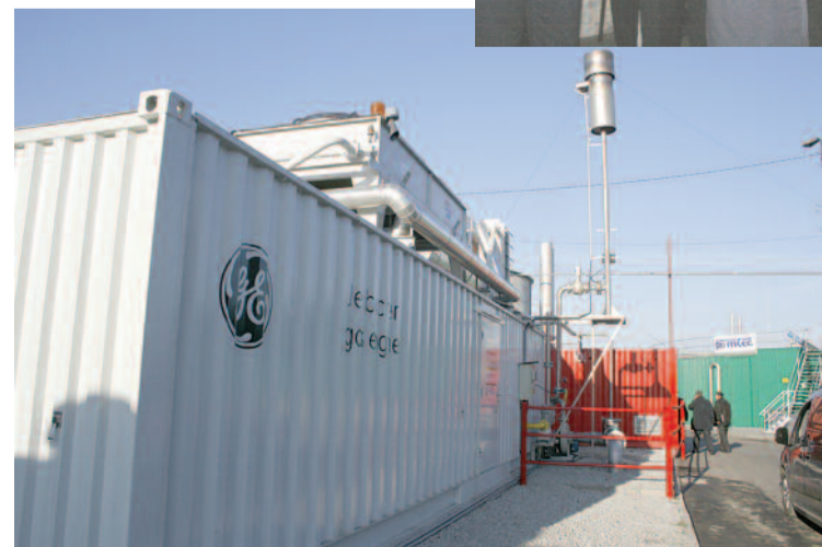
▲ 29 listopada w Lanach Wielkich otwarta została nowoczesna biogazownia zasilająca połączoną z nią gorzelnią. Inwestycja ta jest oparta na nowatorskiej w Polsce technologii i spełnia najwyższe standardy ekologiczne.
