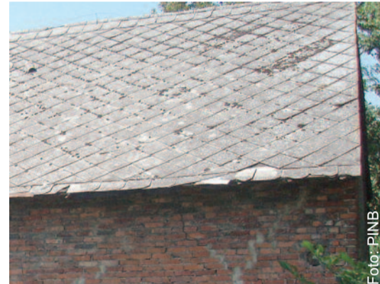
Wciąż nie brakuje domów, pokrytych tym niebezpiecznym materiałem.
