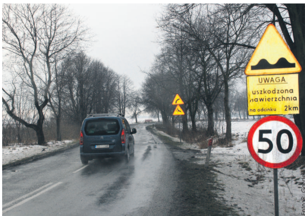
Stan drogi Żernica-Smolnica jest fatalny. Zmieni się to jeszcze w tym roku, przy wsparciu Narodowego Programu Przebudowy Dróg Lokalnych.
