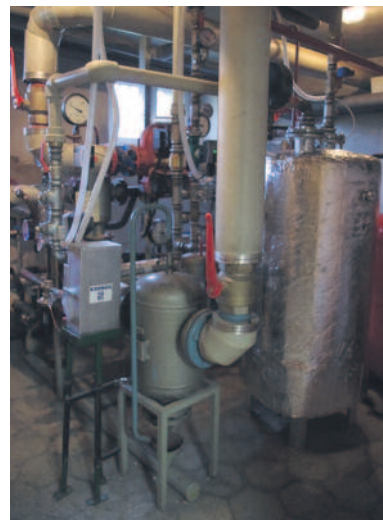
Węzeł wymiennikowy ciepłej wody użytkowej oraz instalacji c. w. u.
