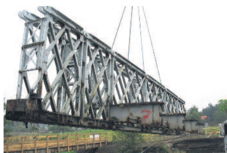
Tak stary most w Leboszowicach przeszedł do historii – by mógł zastąpić go nowy, właśnie budowany.
