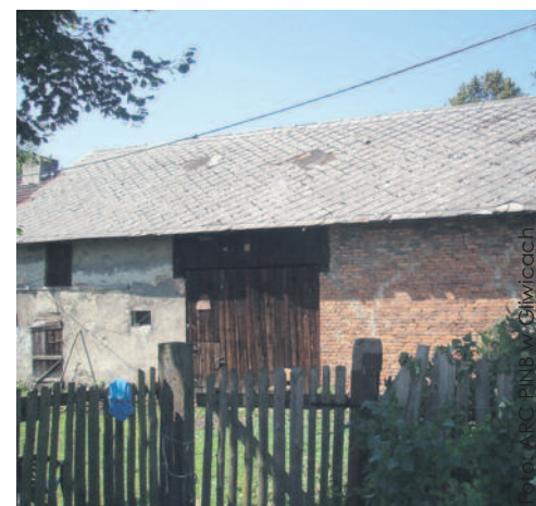
Eternit był niegdyś szeroko stosowany w budownictwie, teraz trzeba się go w bezpieczny sposób pozbyć.
