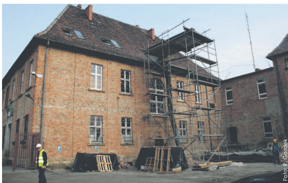
Ruszył długo wyczekiwany remont Komisariatu Policji w Pyskowicach. Budynek zostanie zmodernizowany i dostosowany do nowych standardów, a oczy ucieszy nowa elewacja.
